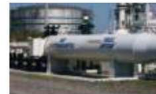
Іл. 43.11. Нафтоперекачувальна станція (Одеса – Броди)
