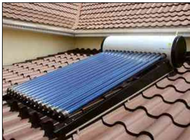
Рис. 106. Вакуумний сонячний водонагрівач
